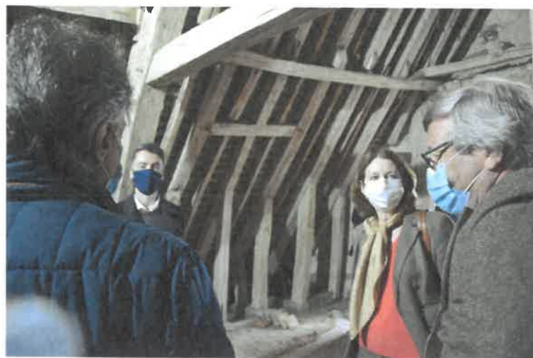
Françoise Tahéri, ici avec Pascal Pecchioli, a pu visiter les combles du manoir de Courboyer et l'état de la charpente. (©Le Perche)
